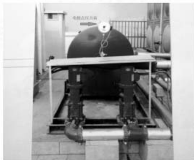
图 4 卧式隔膜式消防气压罐
