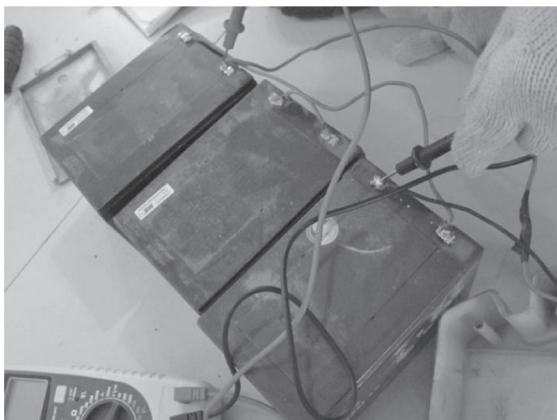
图 5-22 检查蓄电池充电插孔间的电压
