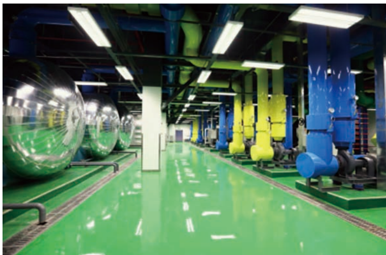
图 9-34 京东云华东数据中心制冷系统
