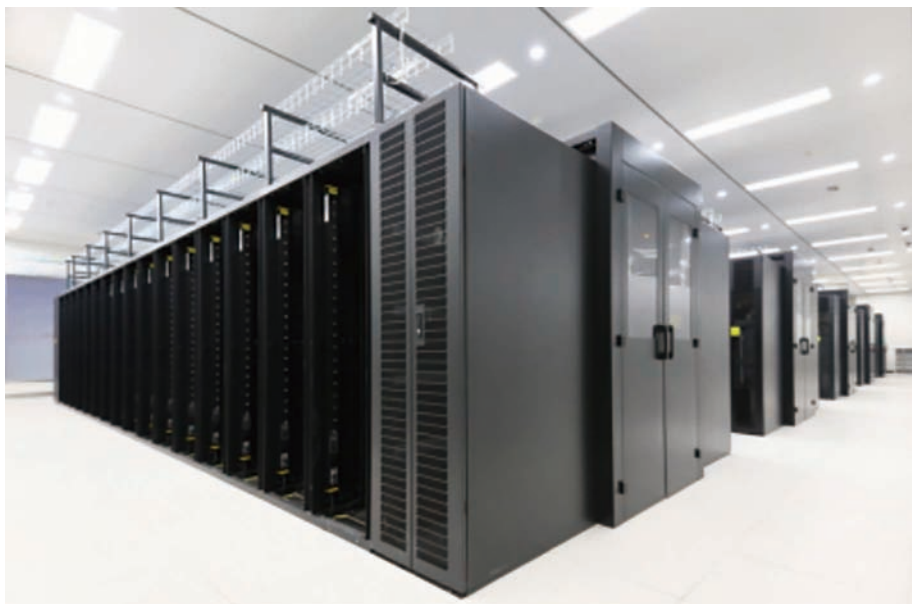
图 9-35 京东云华东数据中心机柜
