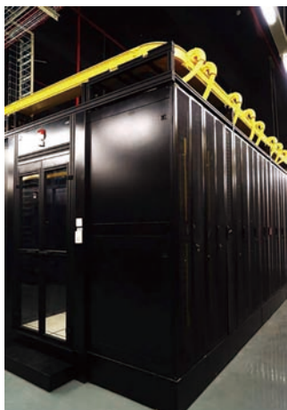
图 9-10 TMDC 腾讯模块化机柜
