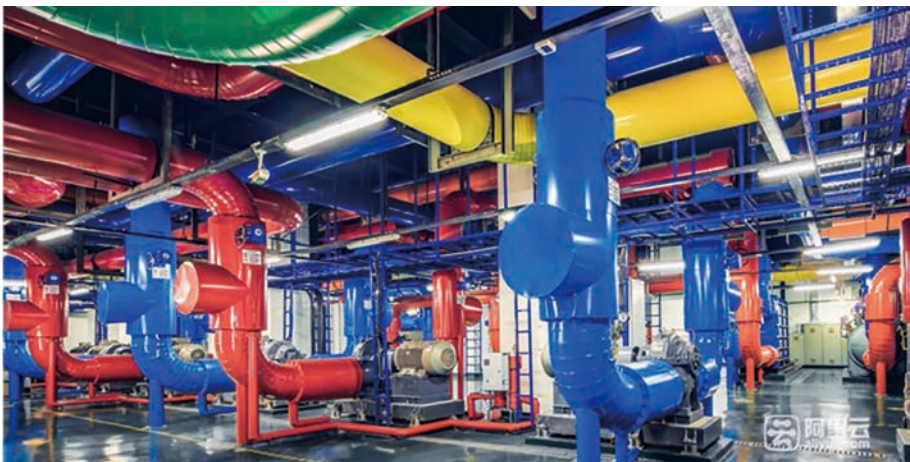
图 9-26 阿里云千岛湖云数据中心冷机房
