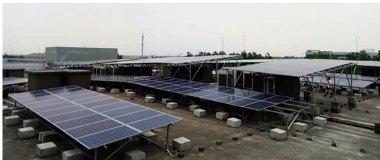
图 9-14 腾讯青浦数据中心光伏发电站
