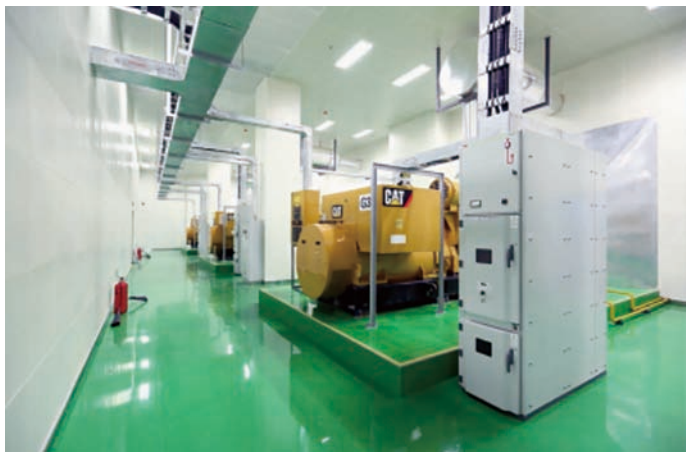
图 9-37 京东云华东数据中心后备柴油发电系统
