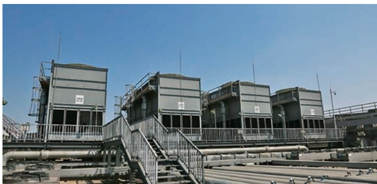
图 9-5 百度云计算(阳泉)中心楼顶的冷却塔
