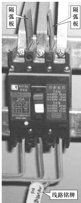
图 1-50 塑壳式断路器 配线过近应加隔弧板
